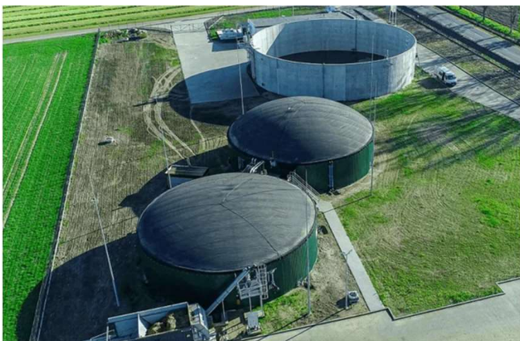
Biogazownia o mocy 499 kWe w Iłowcu Wielkim k. Poznania Źródło: https://www.topagrar.pl/articles/fotowoltaika/biogazownia-rolnicza-w-ilowcu-wielkim-substraty-od-rolnikow-i-przemyslu/
